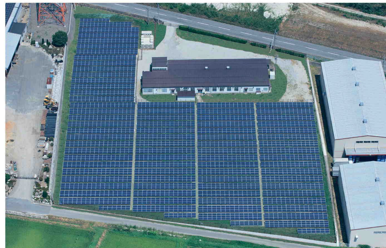
IAM 田切発電所 太陽光パネル864kW 2013年3月15日設置
